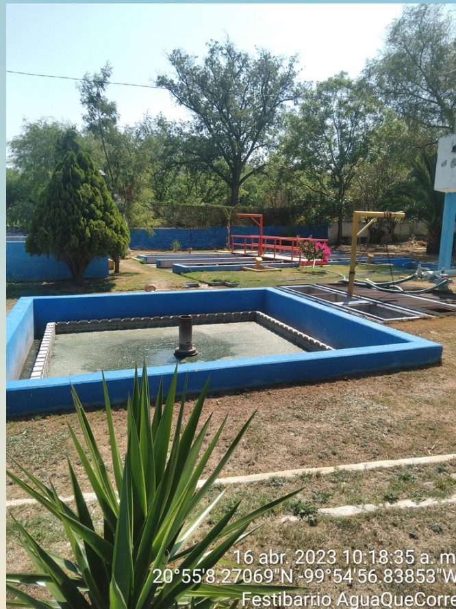
Fotografía: Planta de tratamiento de aguas residuales. Casas Viejas. Abril, 2023.
